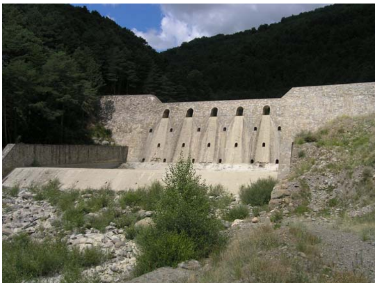
Presas de retención de sedimentos en el barranco de Arás en Biescas. Foto: Alfredo Ollero.
