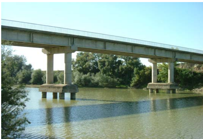
Síntomas de incisión en el puente del río Ebro en Buñuel. Foto: Fernando Magdaleno.
