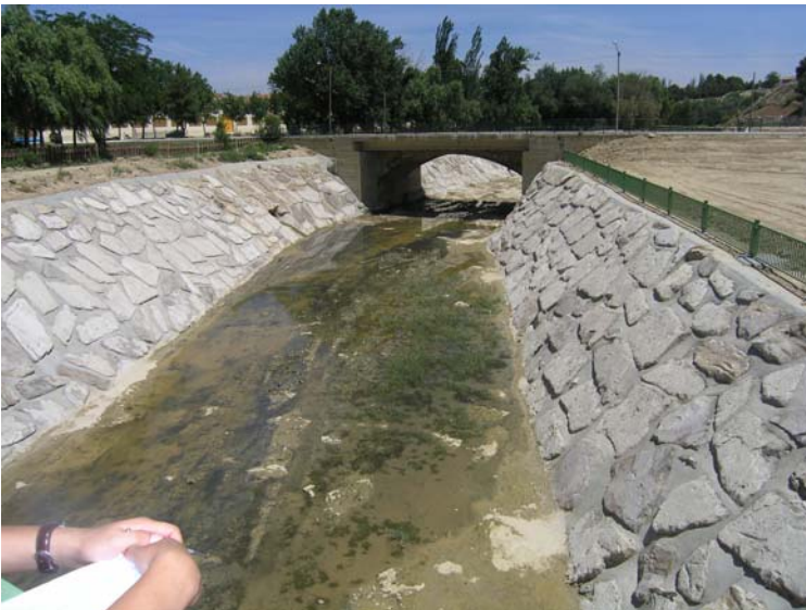
Canalización del río Arba de Biel en Ejea de los Caballeros. Foto: Alfredo Ollero.
