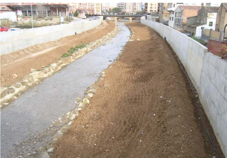
Canalización del río Sosa en Monzón. Además de levantar muros de protección se ha fijado el cauce menor con escollera hormigonada. Foto: Alfredo Ollero.
