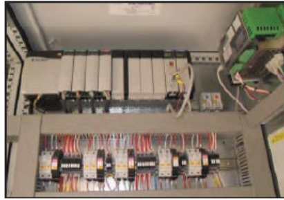
Detalle Rack Ampliación.
